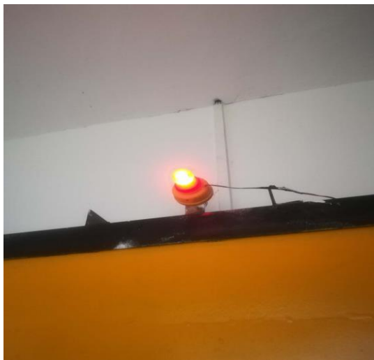
小探伤室警示灯
