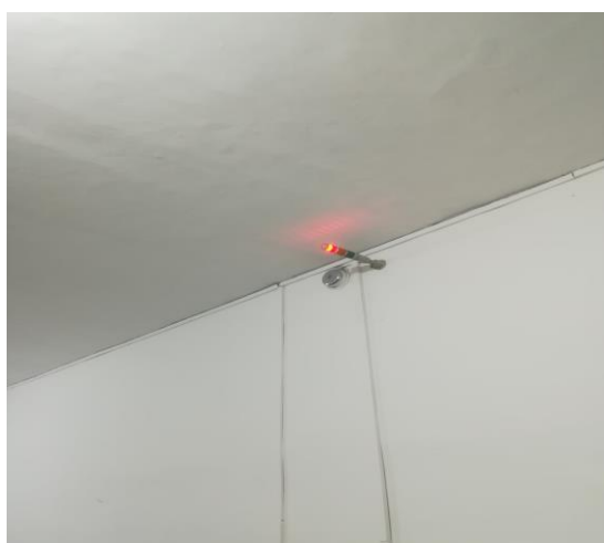
主探伤室内运行指示灯
