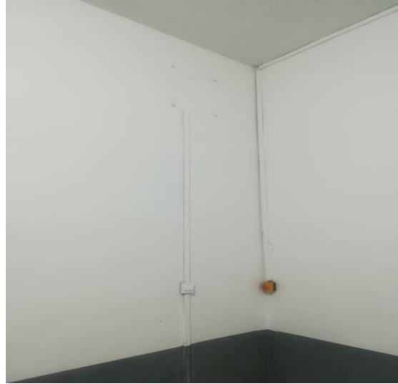
主探伤室东北角急停开关
