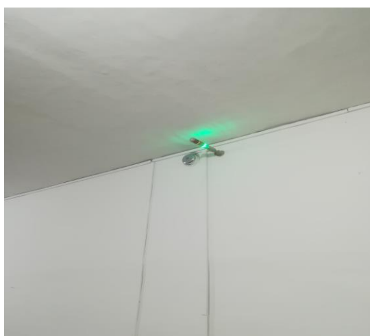
主探伤室得电指示灯
